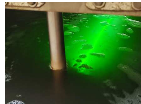
FIGURA 71: Utilização de tratamento UV na ETE
